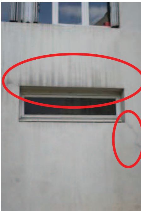
Traces noires et fissures au niveau des façades
