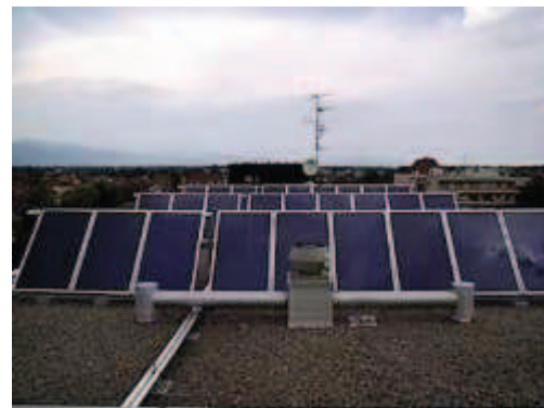
Capteurs solaires thermiques
