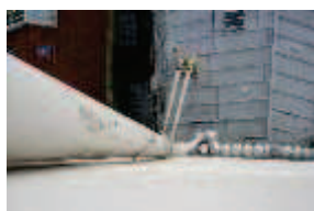
Remontées de gaine de ventilation du restaurant
