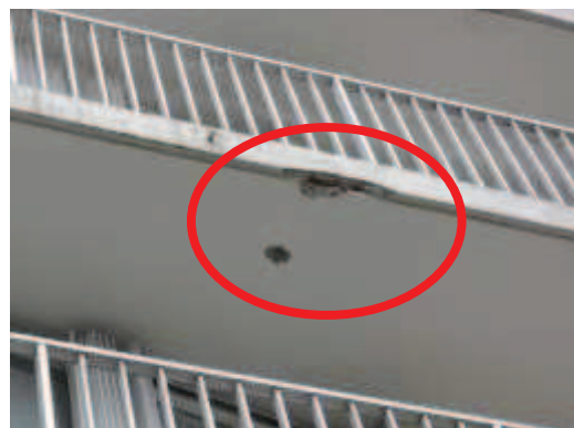
Eclatement du béton dû à la poussée du fer à béton
