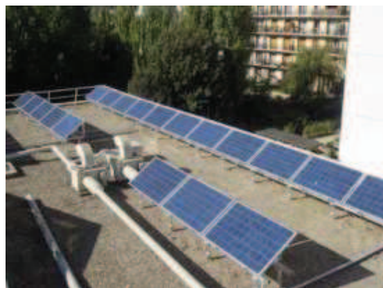
Capteurs solaires photovoltaïques
