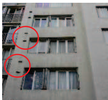
Grilles de ventilation hautes et basses placées en façade
