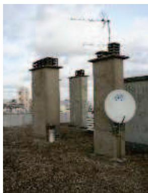
Cheminées des conduits SHUNT
