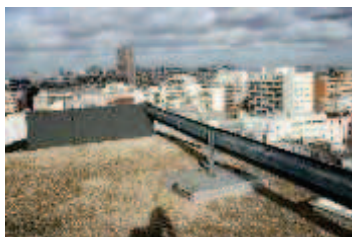
Protection mécanique par gravillons + garde-corps non réglementaire avant novembre 2015
