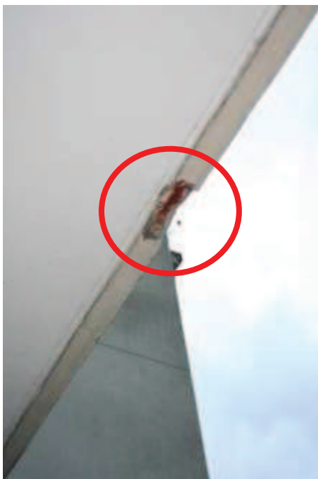
Epaufures au niveau des balcons
