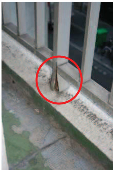
Décollement et oxydation des fixations des garde-corps
